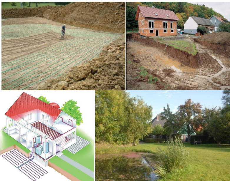
Figuur 3-4 Horizontaal bronleidingen in de bodem, bron: Carrier / Danfoss / Stichting warmtepompen / Nlbe
