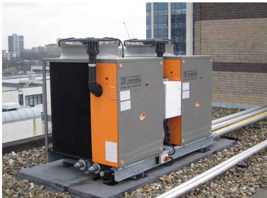
Gasabsorptiewarmtepompen van Remeha verzorgen voor een belangrijk deel de warmtelevering
