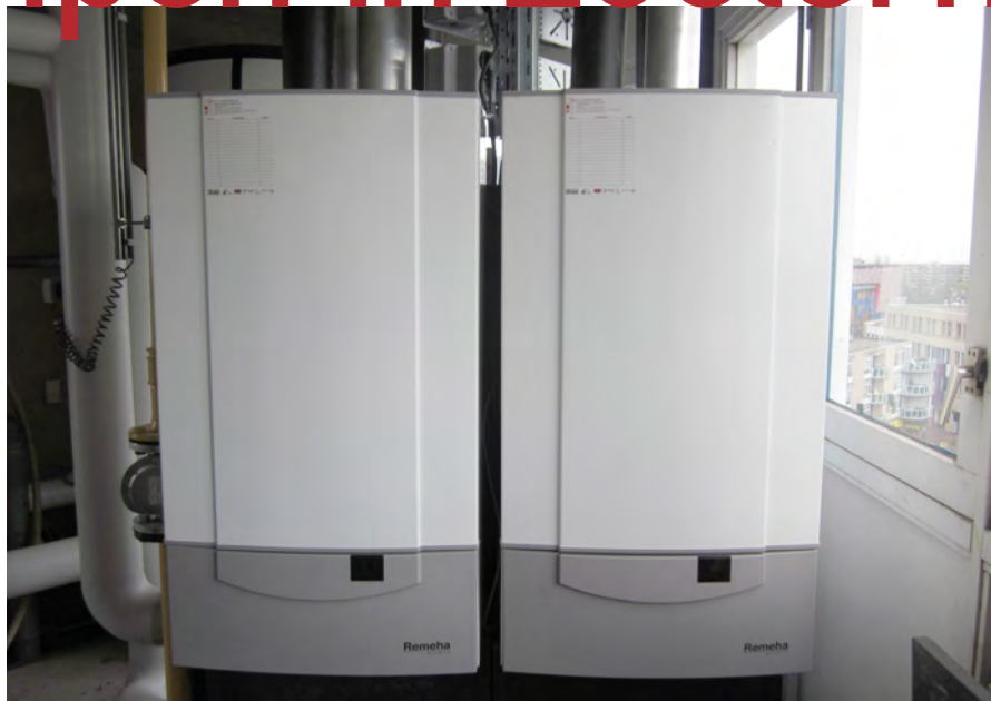
Remeha Quinta ketels vullen de warmtelevering aan
